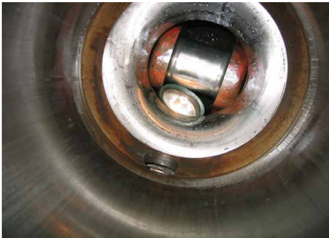
设备运行 100 小时后解体压缩机可以看到缸体布满润滑油珠
