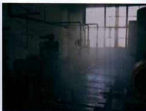
图片为加注 FTJ 前空压机运行情况
